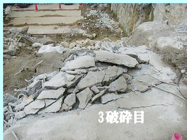
3破碎目の破碎状況。
