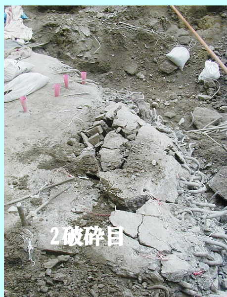
2破碎目の破碎状況。
