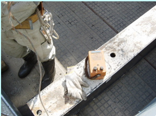
着火器に接続する前に破碎回路全体の抵抗値を測定する
